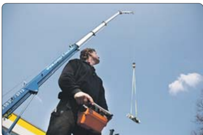
Hoch hinaus: Dirk Hogrefe (42) befördert mit seinem Kran Schweißbahnen zur Dachabdeckung auf eine Fabrikhalle. Der Mit-Geschäftsführer der Zimmerei und Dachdeckerei Compact arbeitet lieber draußen als am Schreibtisch.
